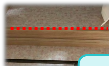
【トイレ前の段差】
