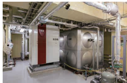
⑪ 機械室[2階] 地中熱利用の冷・暖房システムが設置されています。
