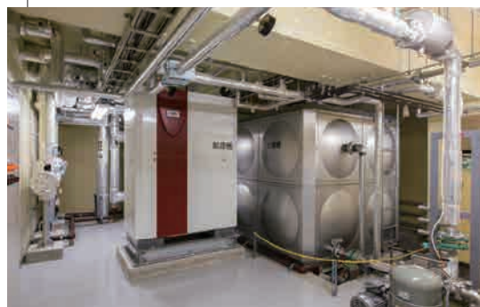
⑪ 機械室 [2階] 地中熱利用の冷・暖房システムが設置されています。
